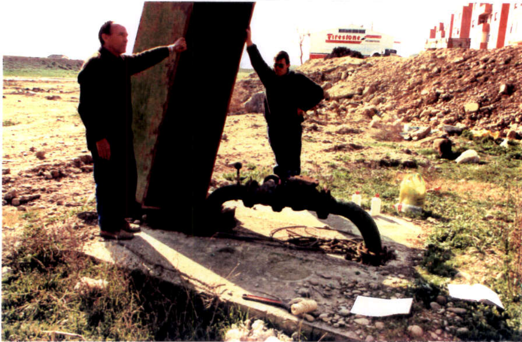
FOTO 1: Captación de aguas subterráneas.
