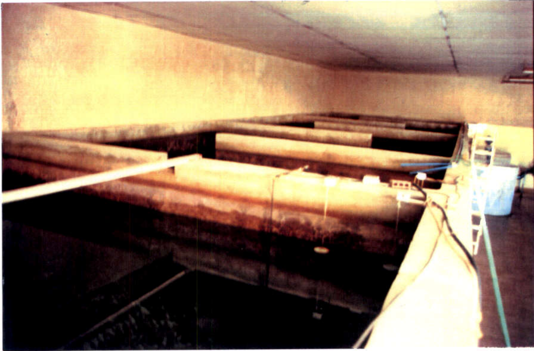
FOTO 3: Depósitos de decantación de la planta potabilizadora.
